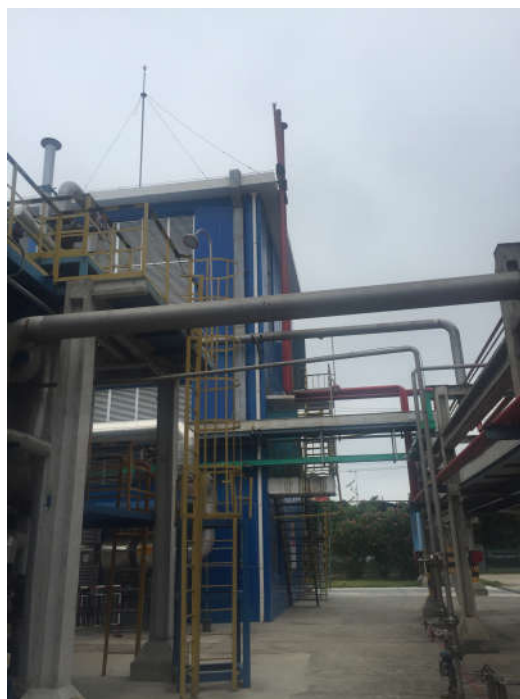
分子筛罐排空 15m 高排气筒
